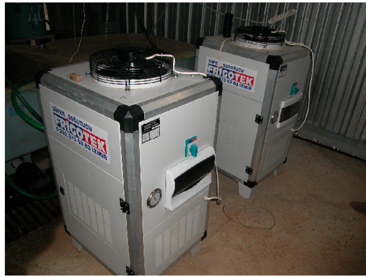
Şekil 9. Suyun ısıtılması ve soğutulmasında kullanılan Frigotek marka soğutucular.
