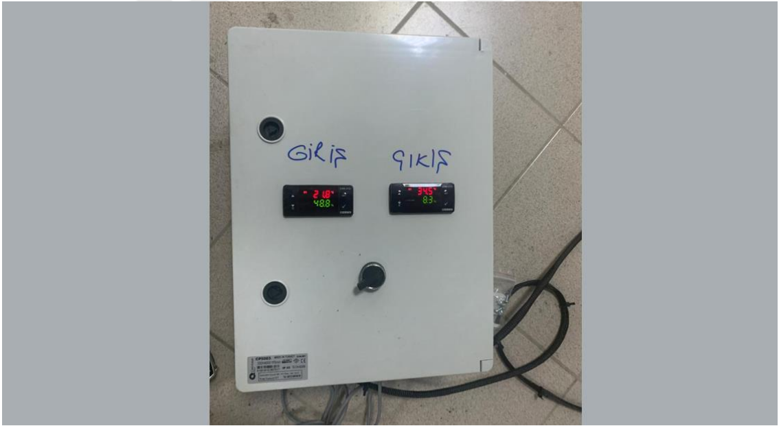
Şekil 5. Nem ve sıcaklık ölçerlerin bağlı olduğu elektrik panosu
